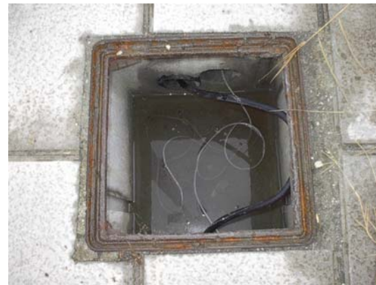
Arqueta Telefónica Tipo H
