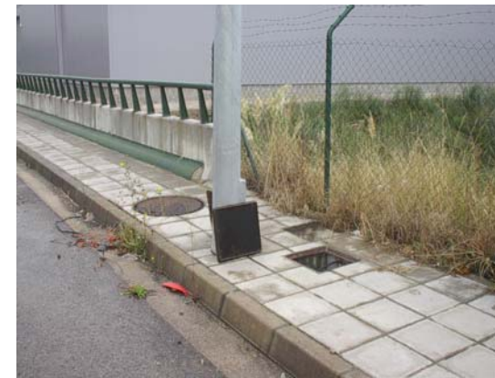
Arqueta Telefónica Tipo H
