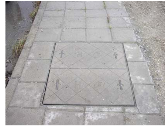
Arqueta Telefónica Tipo H
