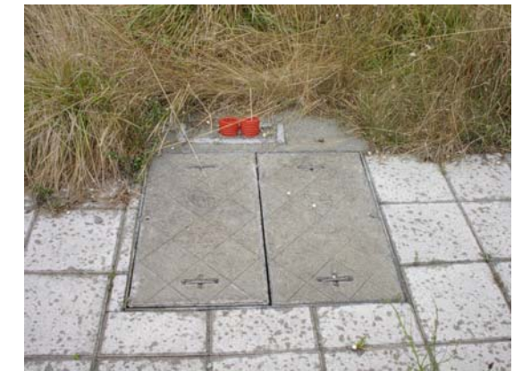
Arqueta Telefónica Tipo H
