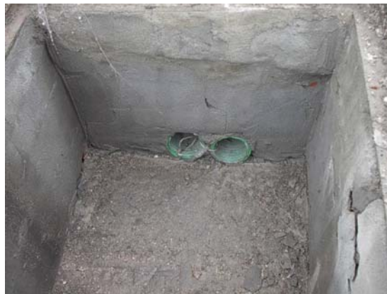
Arqueta Telefónica Tipo H
